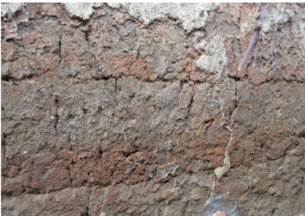
Abb. 101: Nahansicht der in Wuzelbautechnik errichteten, massiven Lehmmauer aus Frauendorf an der Schmida mit den Spuren eines Schadfeuers (Foto: R. Meingast, Fotonr. 2671, Veröffentlichung mit freundlicher Genehmigung von R. Meingast).
