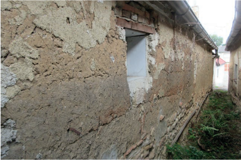
Abb. 100: In Wuzelbautechnik errichteter neuzeitlicher Massivlehmbau aus Frauendorf an der Schmida. Spuren eines Schadfeuers sind als dünne, rötliche Verziegelungsschicht an der Wandoberfläche zu erkennen (Foto: R. Meingast, Fotonr. 2670, Veröffentlichung mit freundlicher Genehmigung von R. Meingast).
