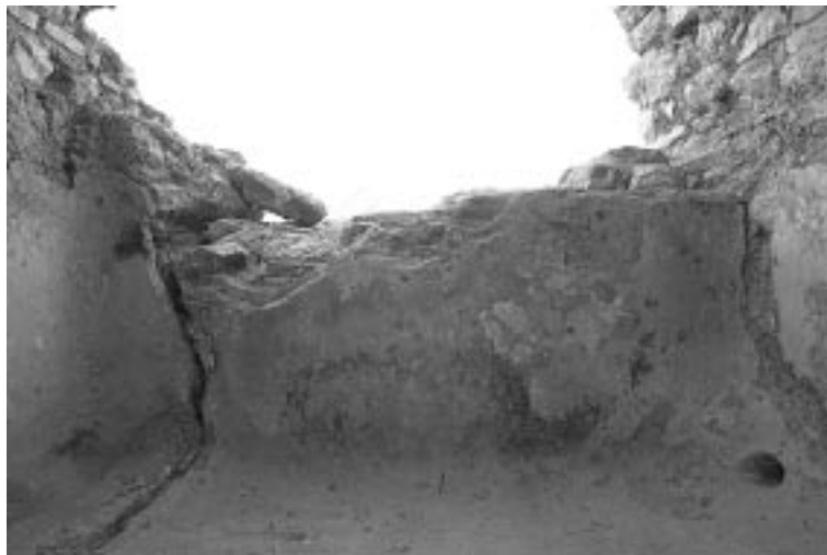
2 Ephesos, sog. İsa Bey Hamamı. Setzungsriß im Bereich des Warmwasserspeicherraumes (R 12)
