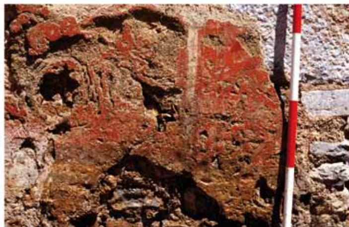
Abb. 5: Putz mit rotem Malgrund an M01-27.II
