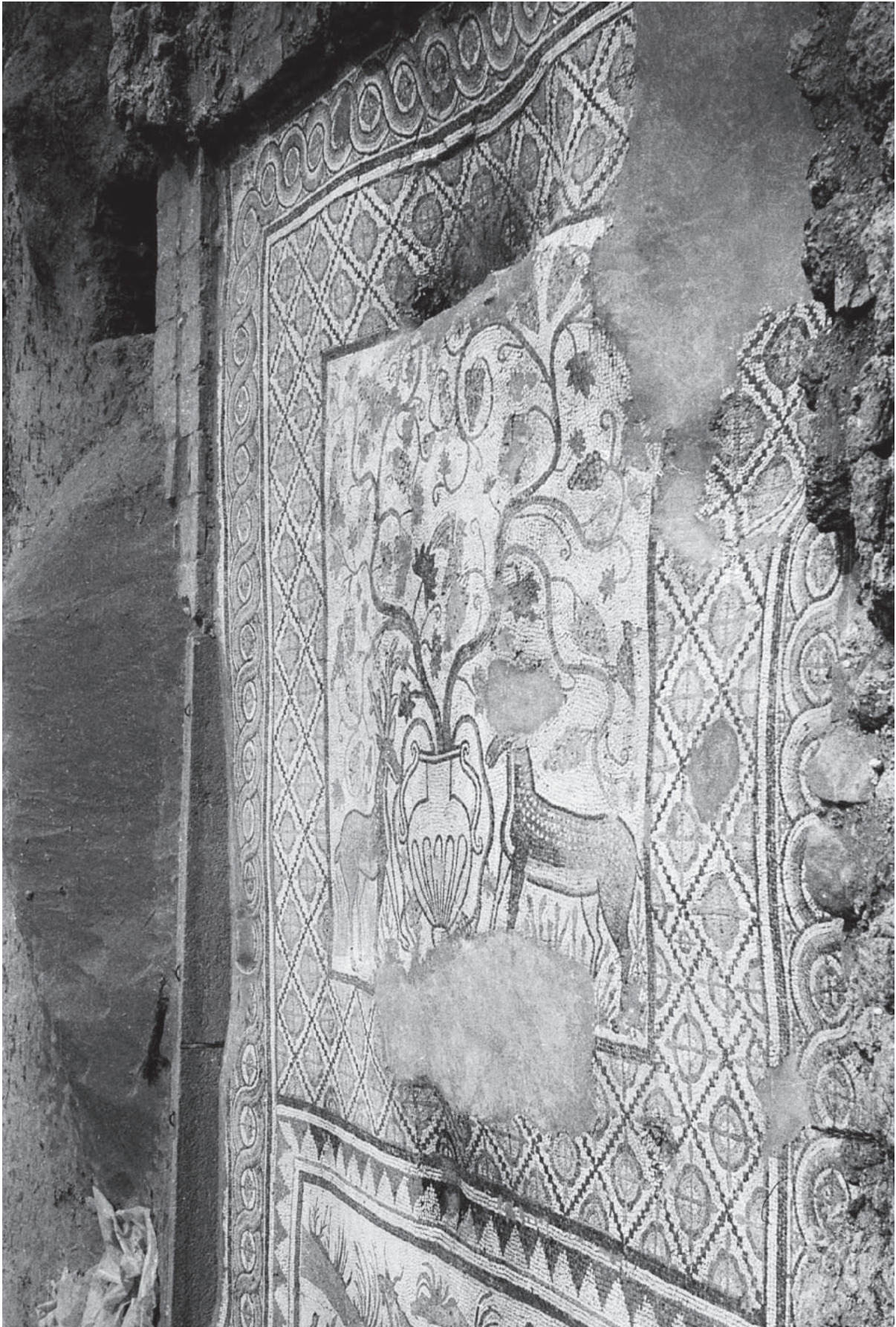
Abb. 6: Bodenververfungen im Mosaikboden
