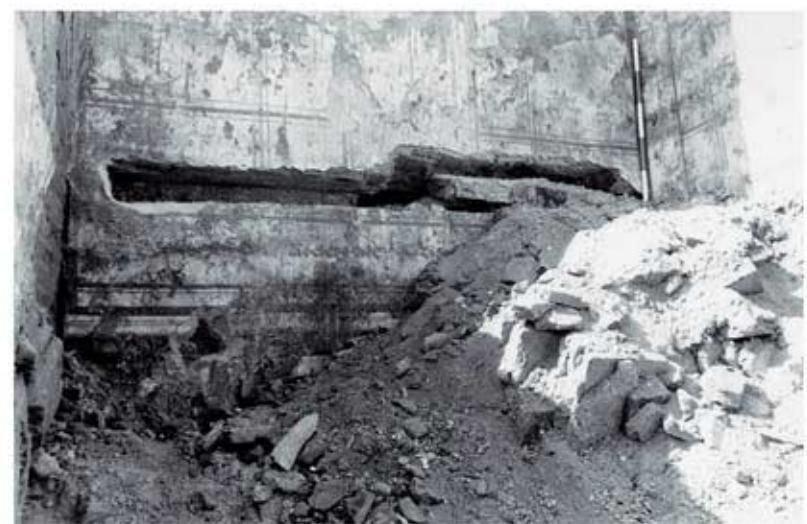
14.7: Raum 15, S-Wand; Hohlraum mit Resten eines verbrannten hölzernen Mauerankers
