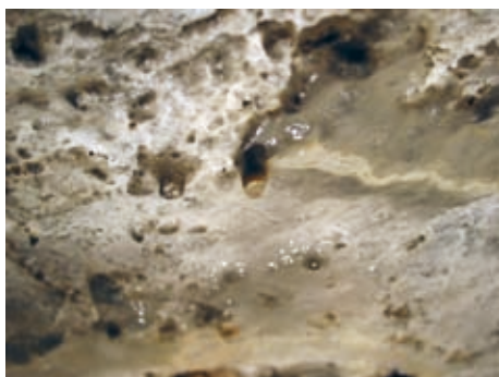
Abb. 26: Tropfenbildung an der Höhlendecke infolge von Wasserinfiltration nach einer Niederschlagsperiode im Spätwinter.
