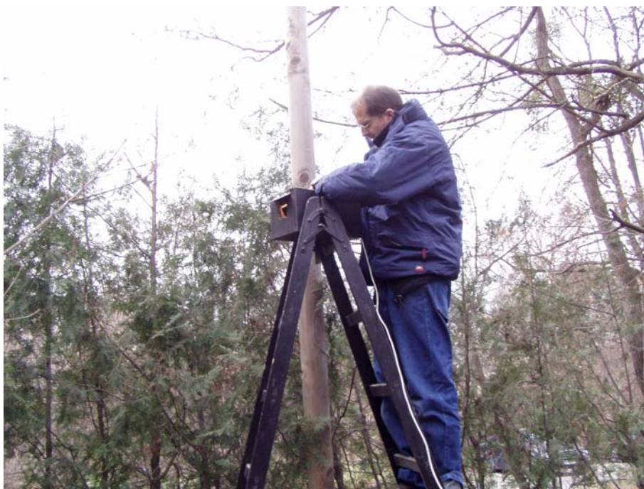
Foto 3-2: Installation einer halb-automatischen Zählstation an einem BR Eingang
