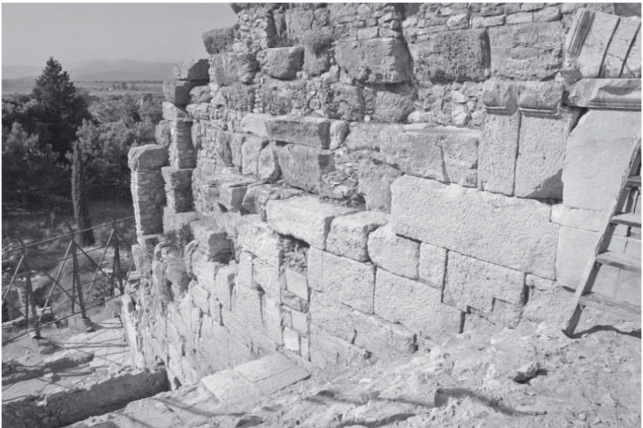
Abb. 561: Südfassade des Theaters mit Stufenabdrücken zwischen ES1 u. ES2, von SO
