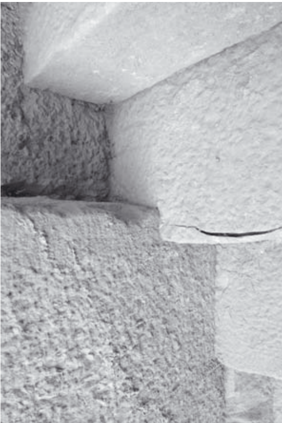
Abb. 566: Treppe-West, Stufen östlich ESI, Anschluss an Torpfeiler
