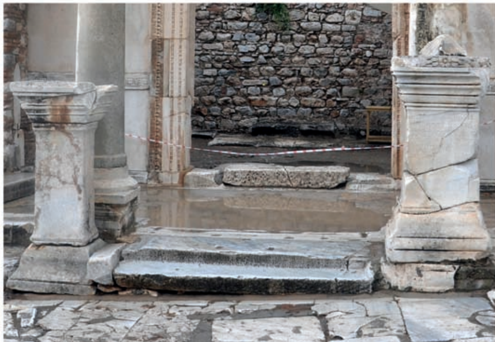
2 Wasserlachen im Bereich der Vorhalle und der Cella nach starken Niederschlägen
