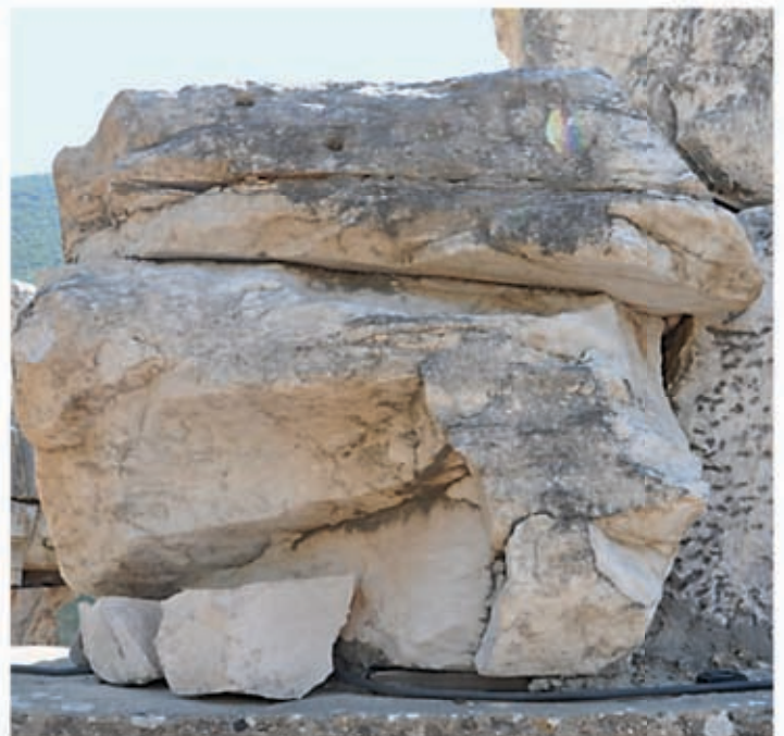
4 Risse an 099D , Rückseite
