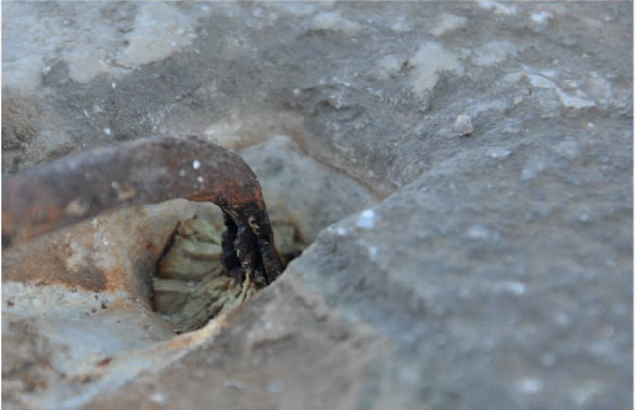
1 Verstärkte Korrosion am Klammeransatz infolge einer möglichen Wechselwirkung mit dem verwendeten Klebstoff
