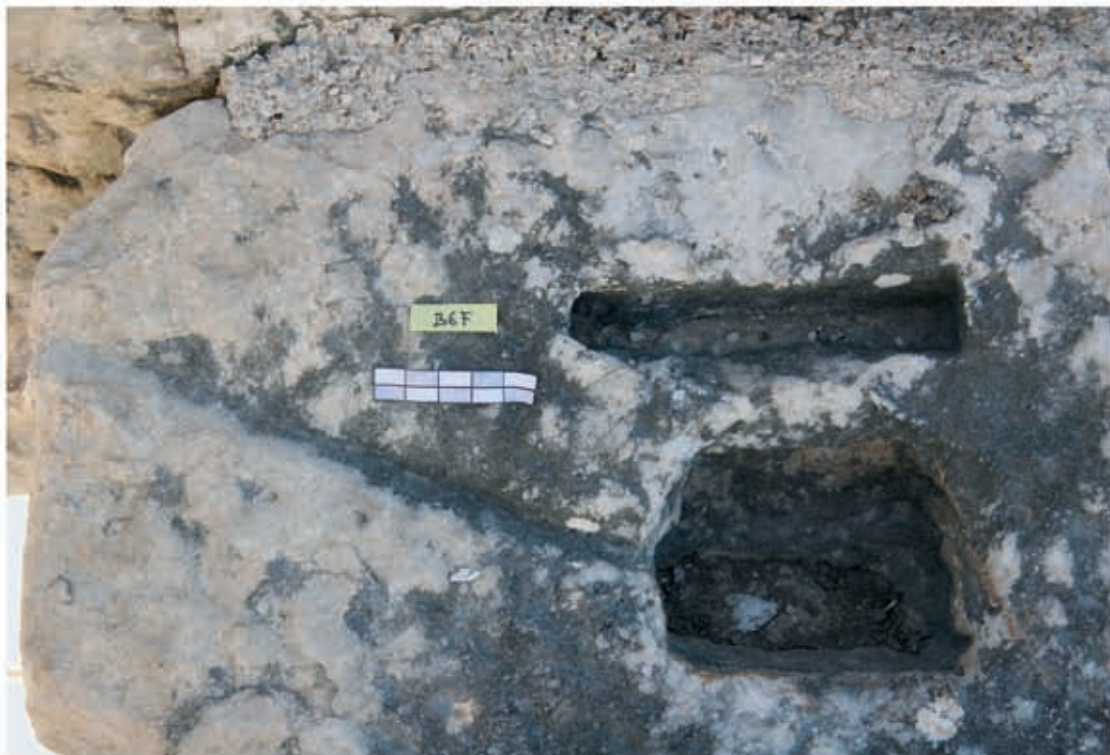
2 Dübelloch mit Gusskanal am Ansatz des Gurtbogens (111D)
