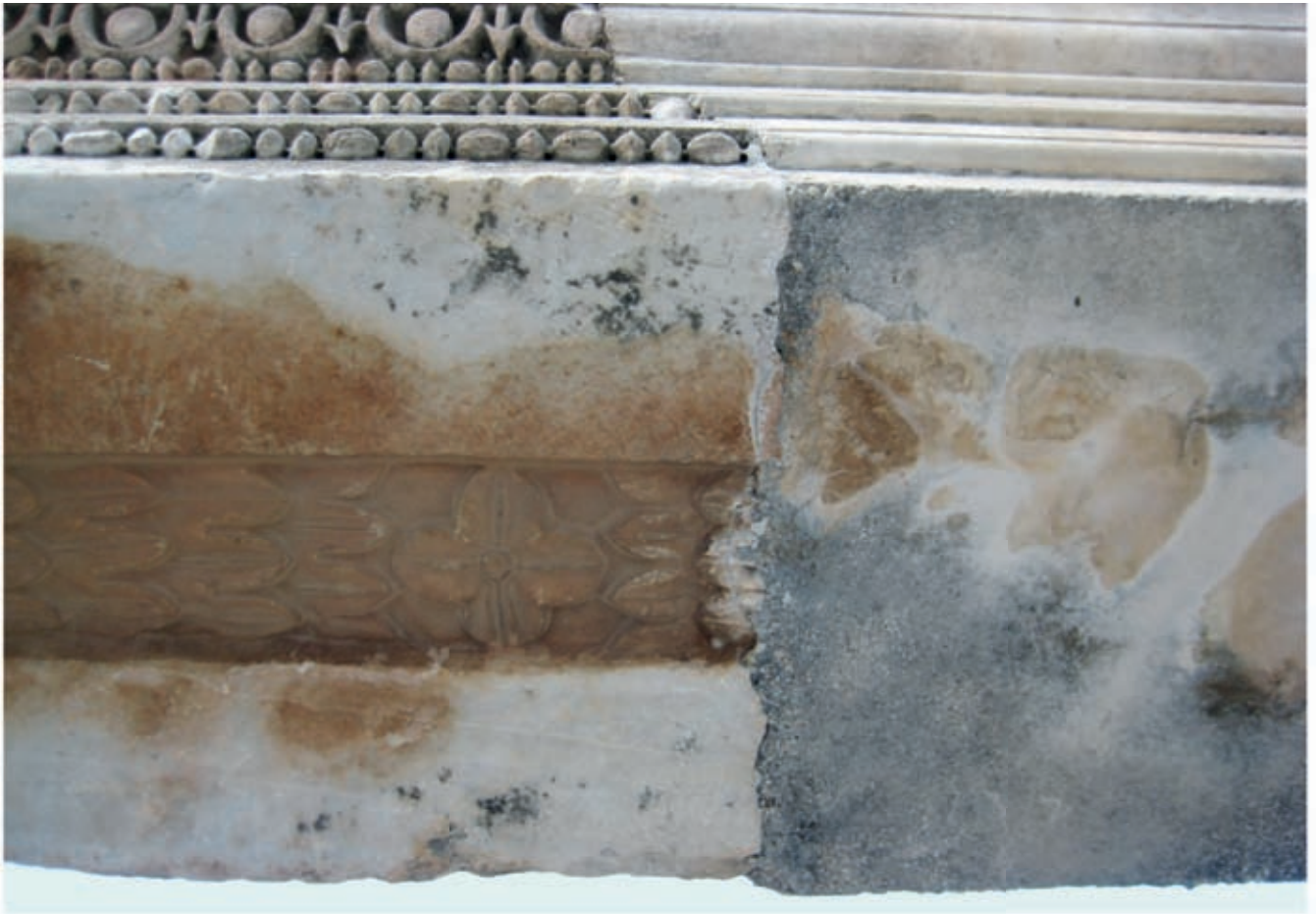
1 Kalksinterkruste an der Unterseite von Architrav 029A
