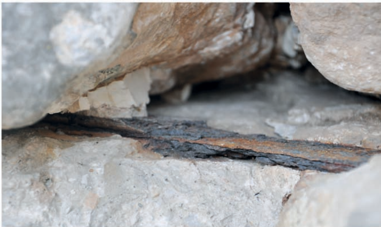
2 Stark korrodierte Klammer in der Lagerfuge der Südostecke (040A. 089A)
