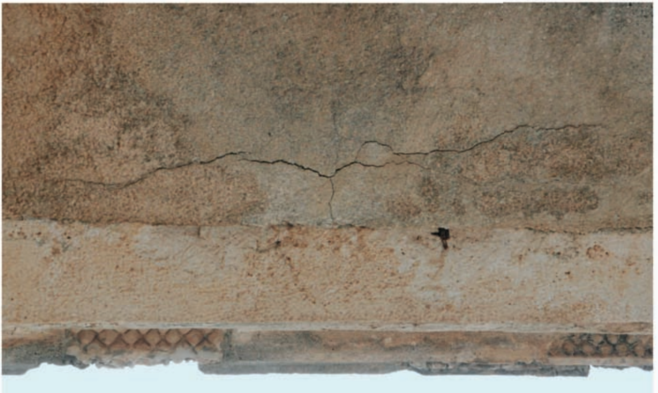
2 Rissbildung des Betons im Bereich des Türsturzes des Cellaportals
