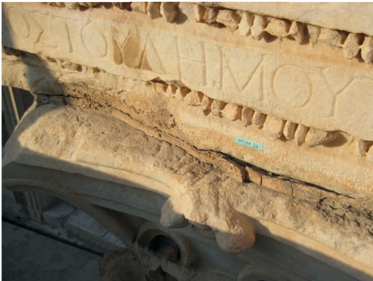
1 Geschädigte Fugenmasse im Bereich der Marmorbauteile
