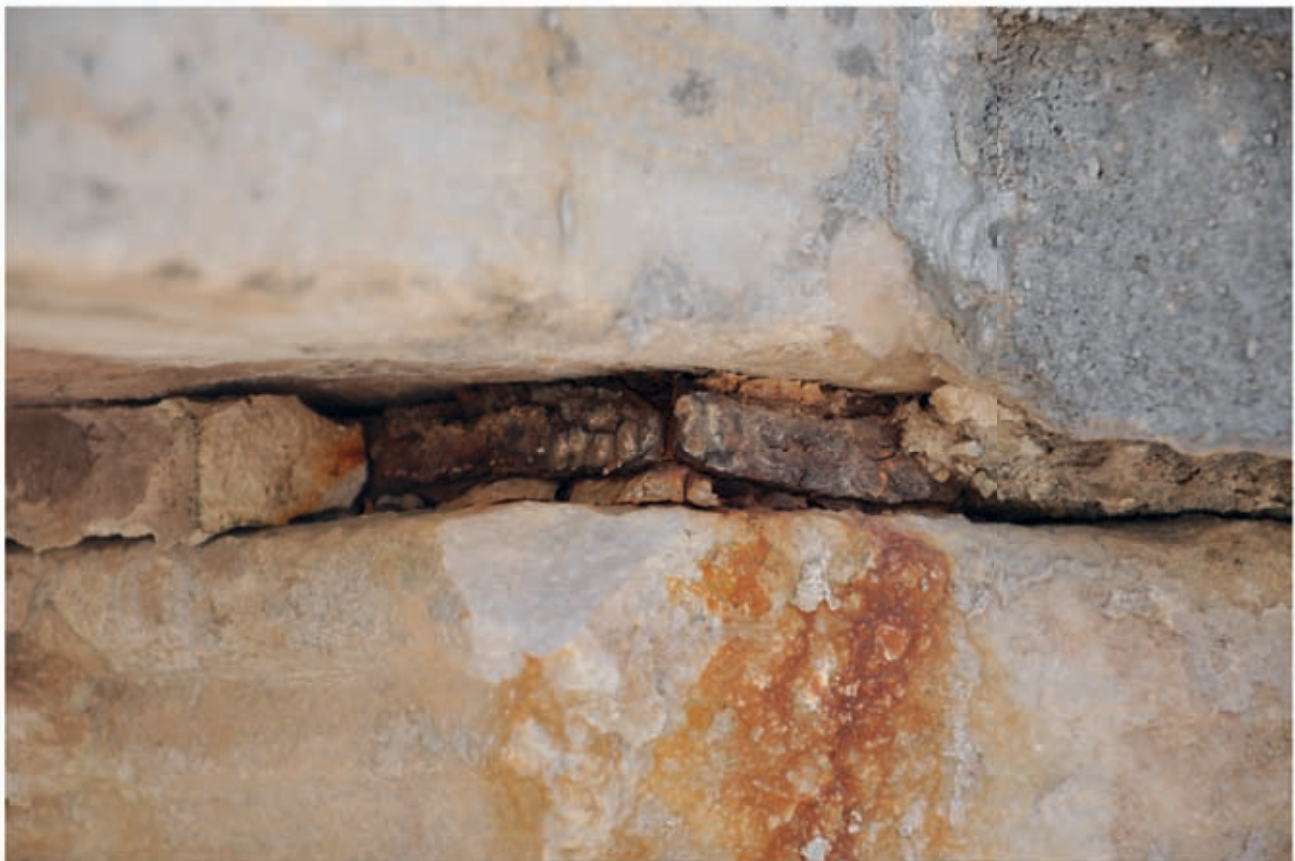
2 Abstandhalter aus Eisen im Fugenbereich zwischen 025K und 040A : die Korrosion führt zu Schaden an der Fugenmasse und zu Verfärbungen
