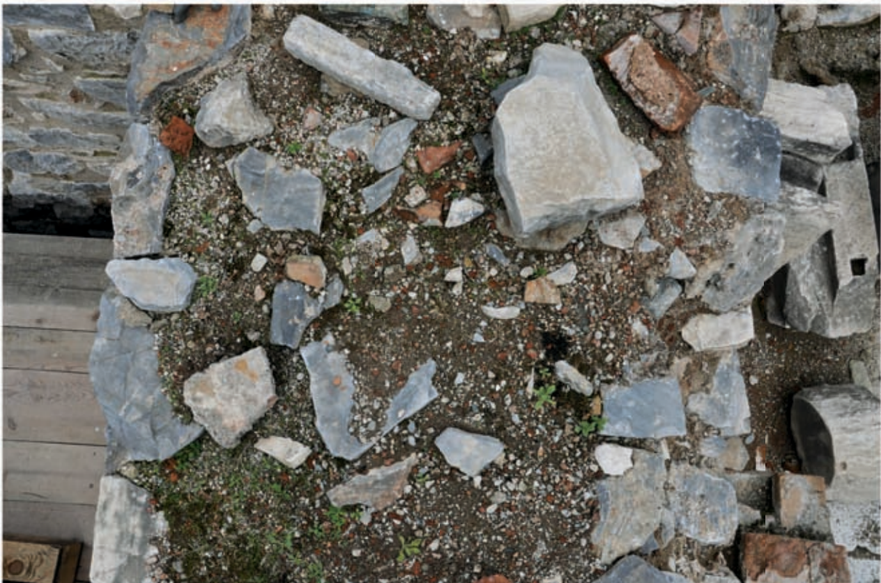
2 Durch Niederschlagswasser geschädigte Mauerkrone des Bruchsteinmauerwerks
